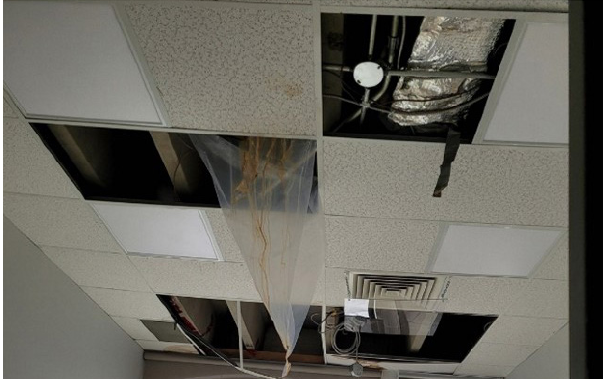
Conduits de ventilation en mauvais état
