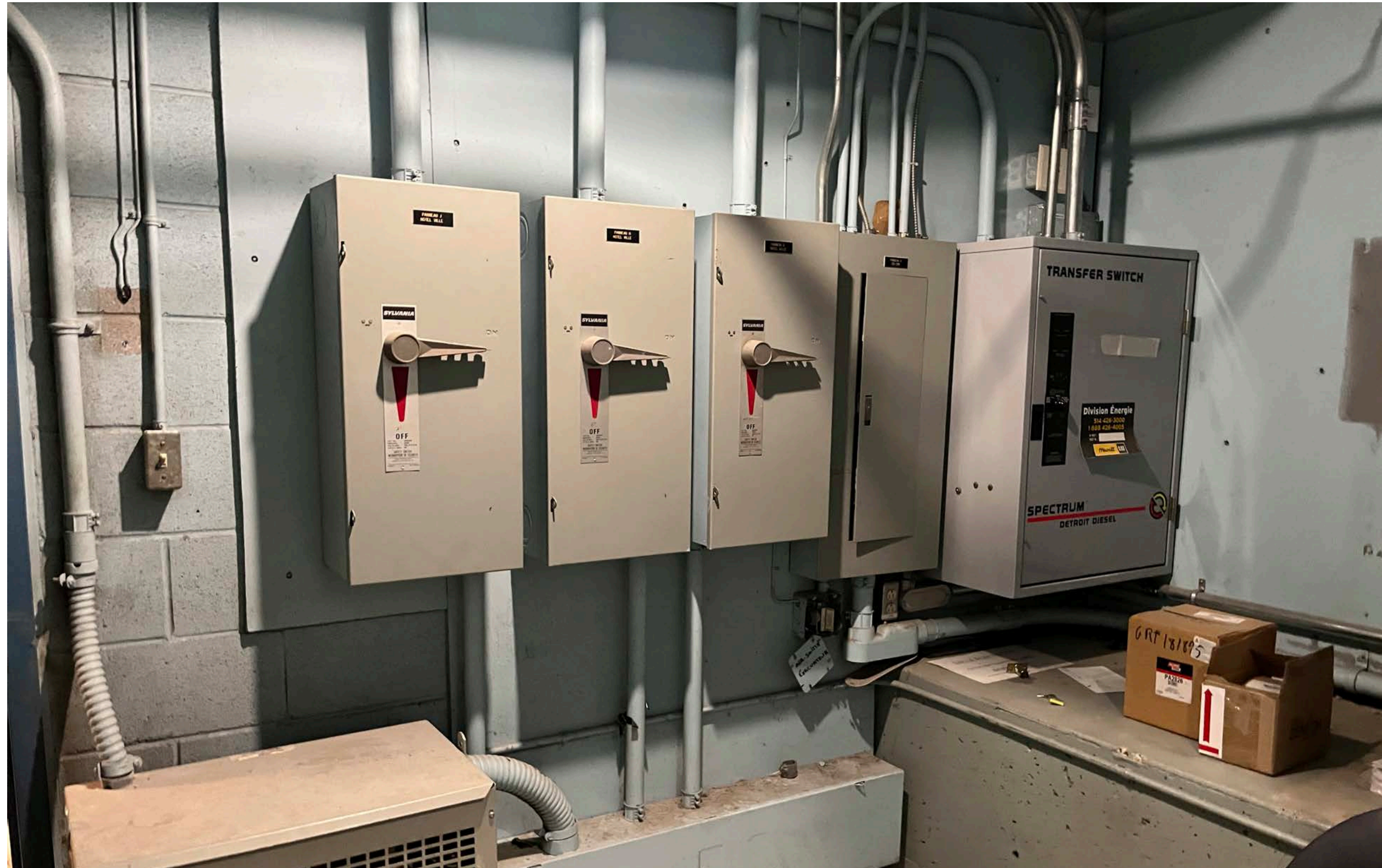
Panneaux électriques en fin de vie
