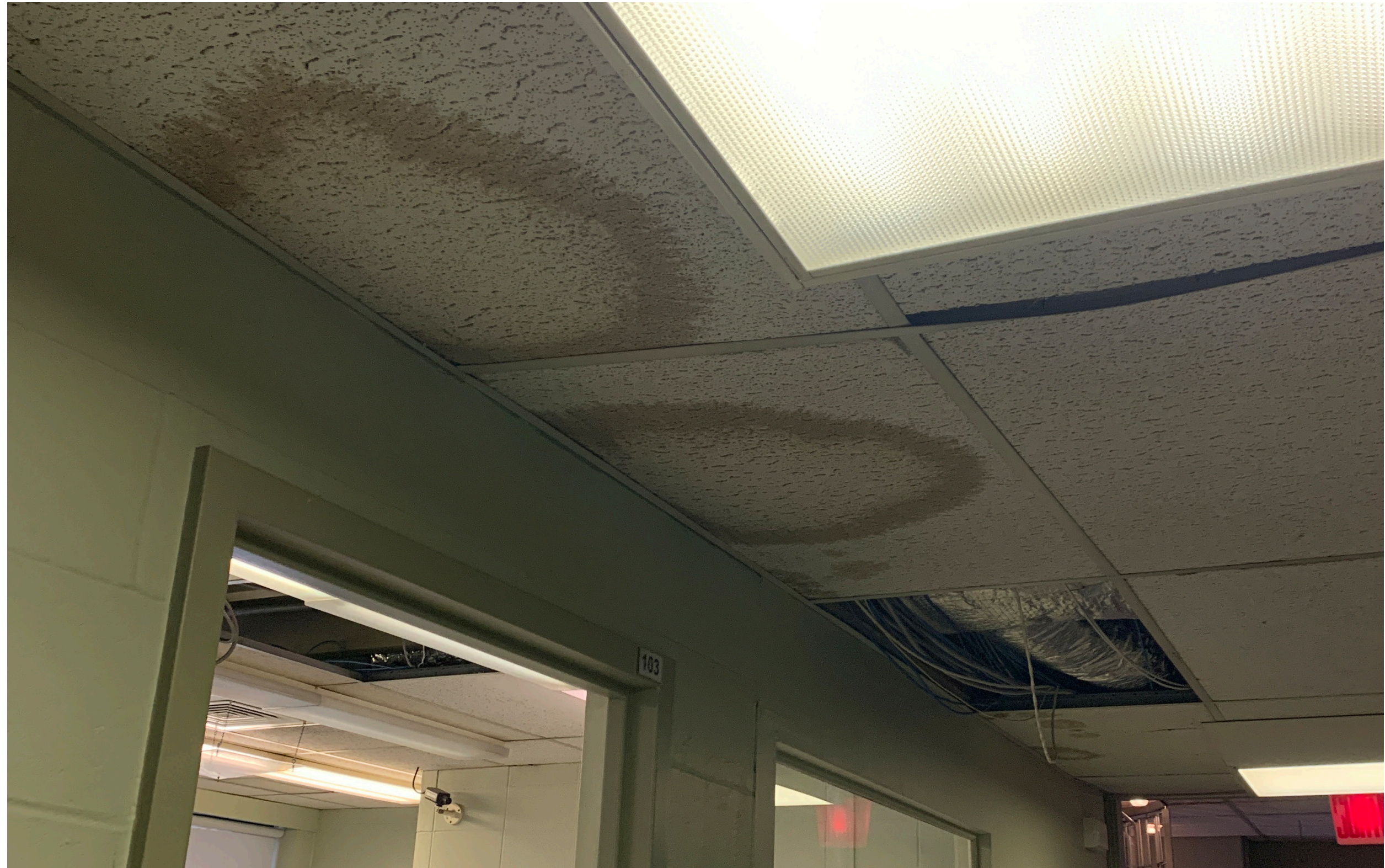
● Signe d'infiltration d'eau au rez-de-chaussée du bâtiment administratif
