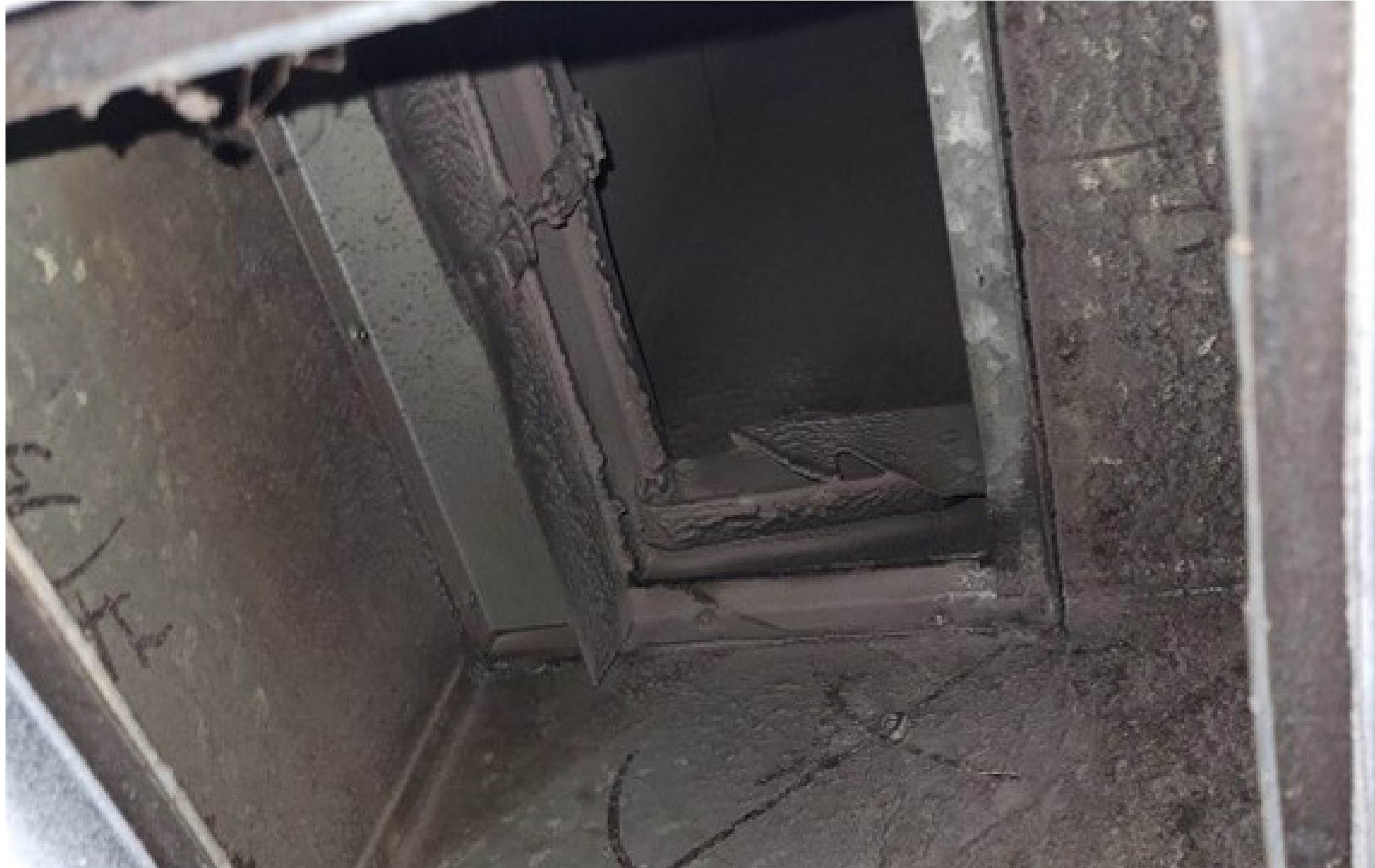
Conduits de ventilation en mauvais état
