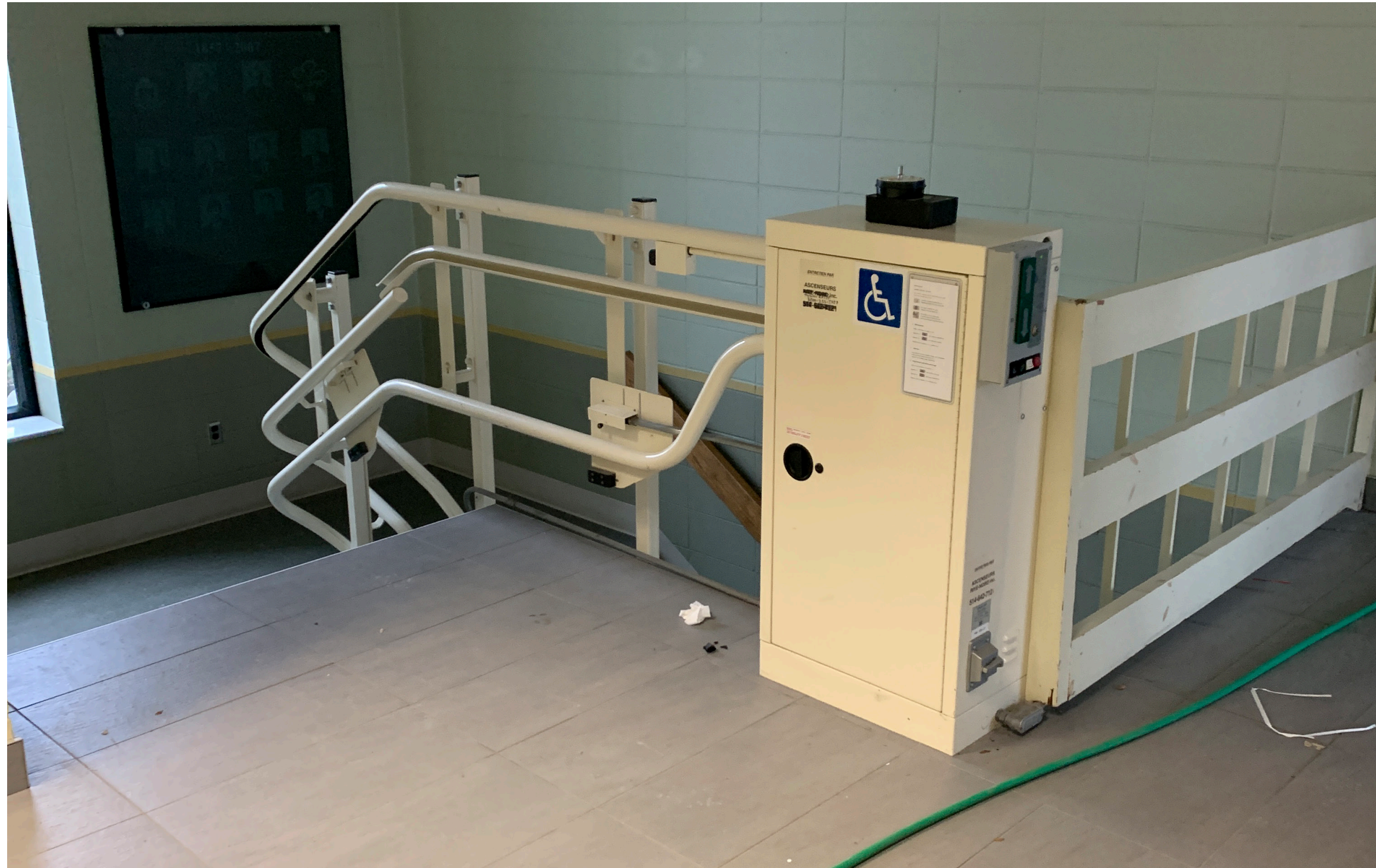
Mécanisme lève personne pour accéder à l'étage
