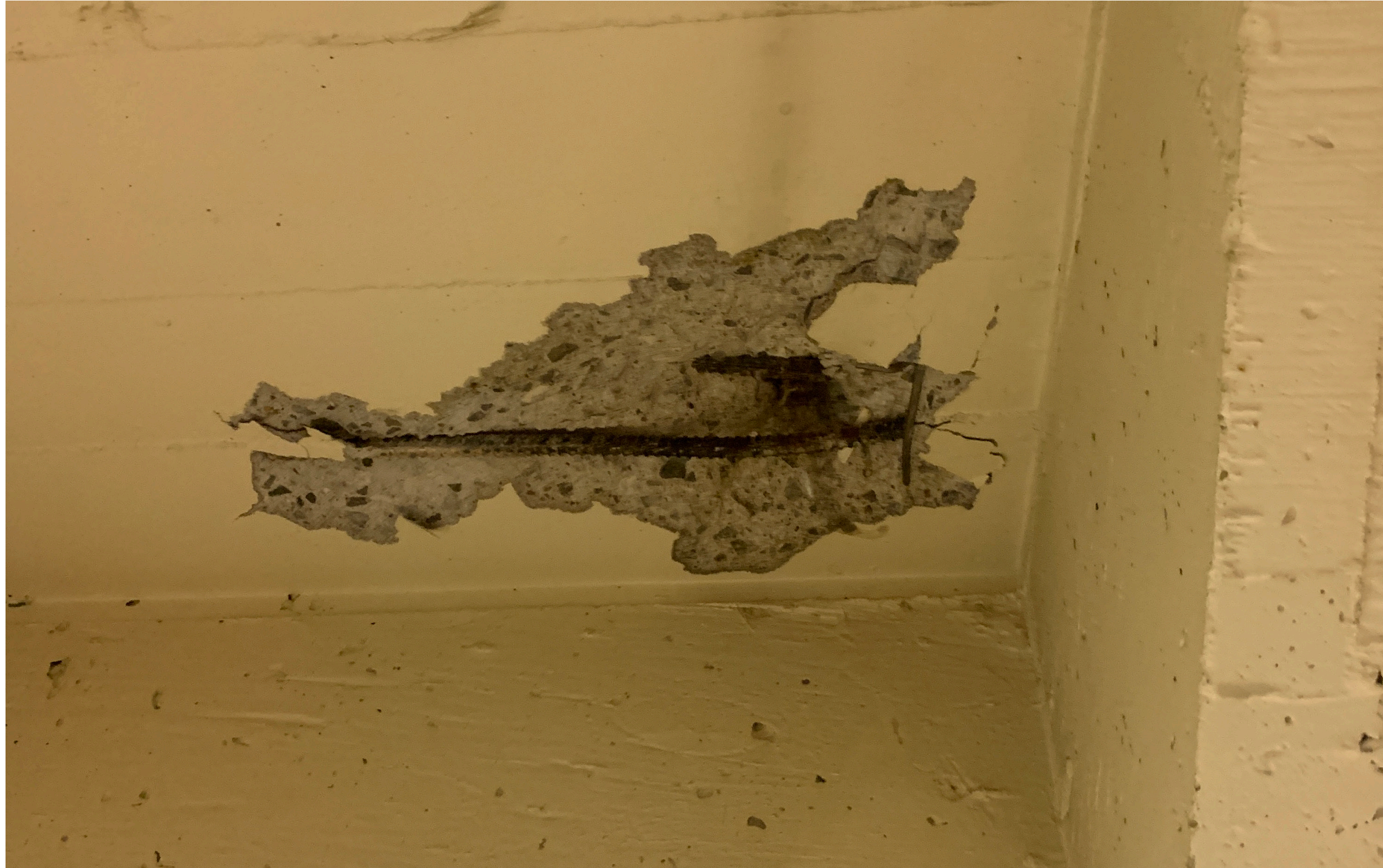
● Armature de béton apparente et corrodée
