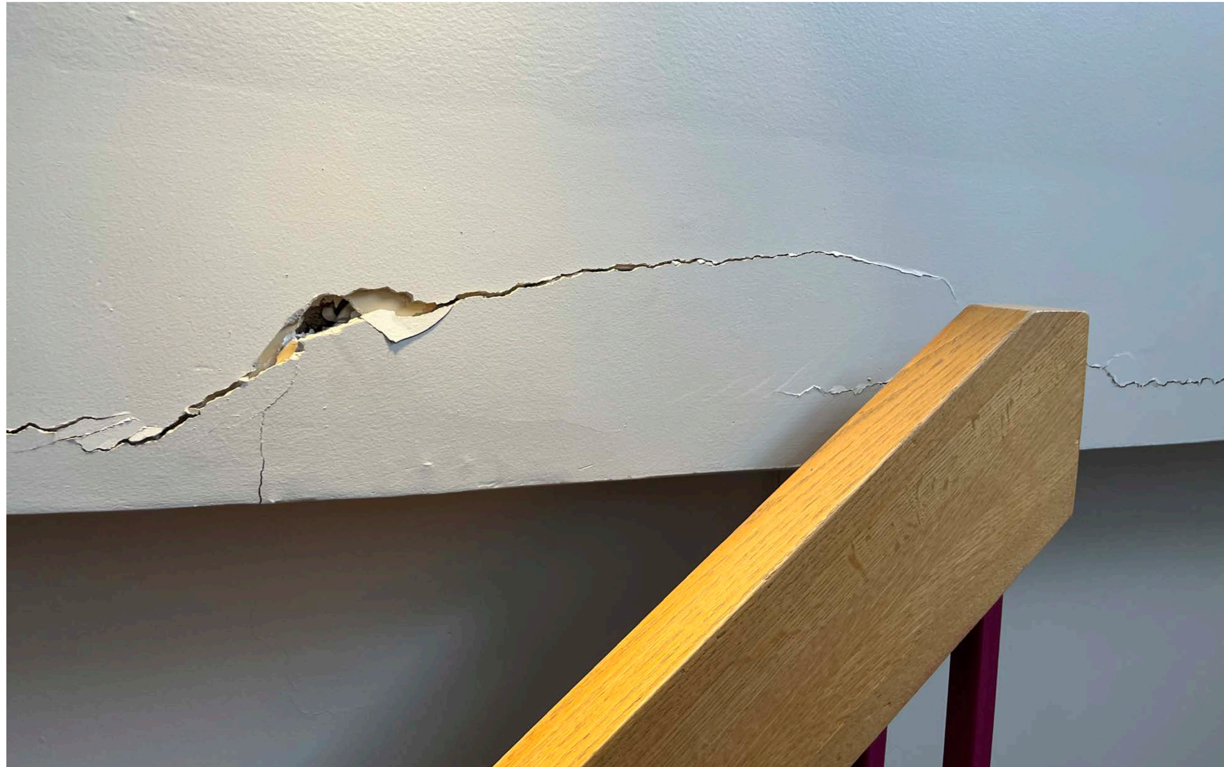
Fissure au mur de la cage d'escalier dans la section originale
