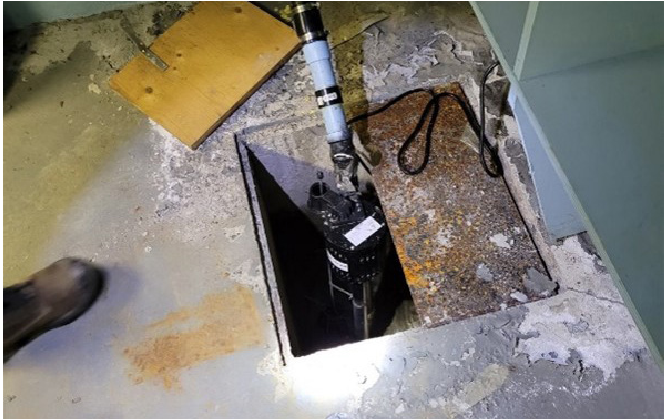
Pompe submersible et puisard en fin de vie
