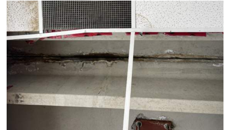
Traces d'infiltration d'eau dans l'entre-plafond sous le toit
