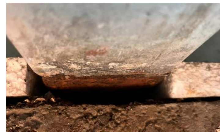
Système d'ancrage en acier corrodé de la dalle-poutre à l'appui du linteau-poutre
