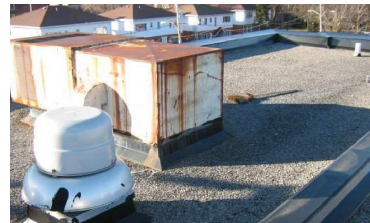
Roof Condition Assessment Report, Ville de St-Lambert, 55 Argyle, Premier Levaque Inc, décembre 2010, p 12
