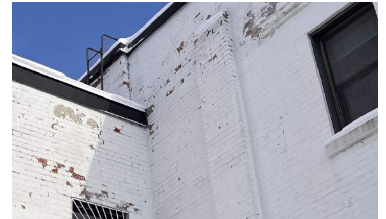
Possible délamination de la brique en partie haute.
