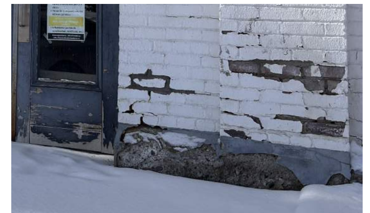
Désordre au niveau des jambages de la porte.
