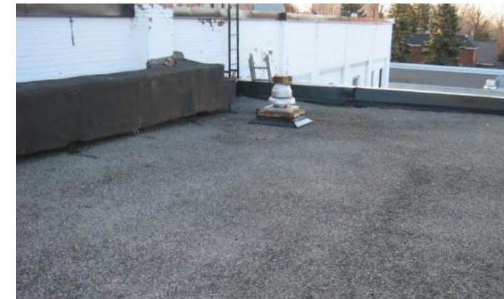
Roof Condition Accessment Report, Ville de St-Lambert, 55 Argyle, Premier Levaque Inc, décembre 2010, p 4
