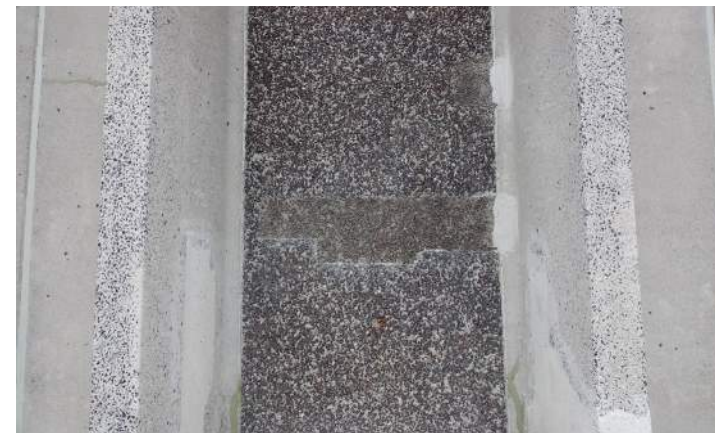
Réparation de béton avec agrégat, Centre de service MTMDET Beaupré-Michaud at Associés architectes, 2016
