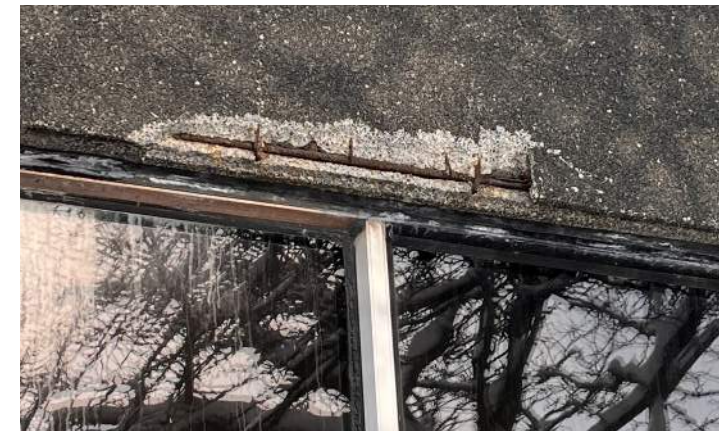
Délamination d'un linteau-poutre
